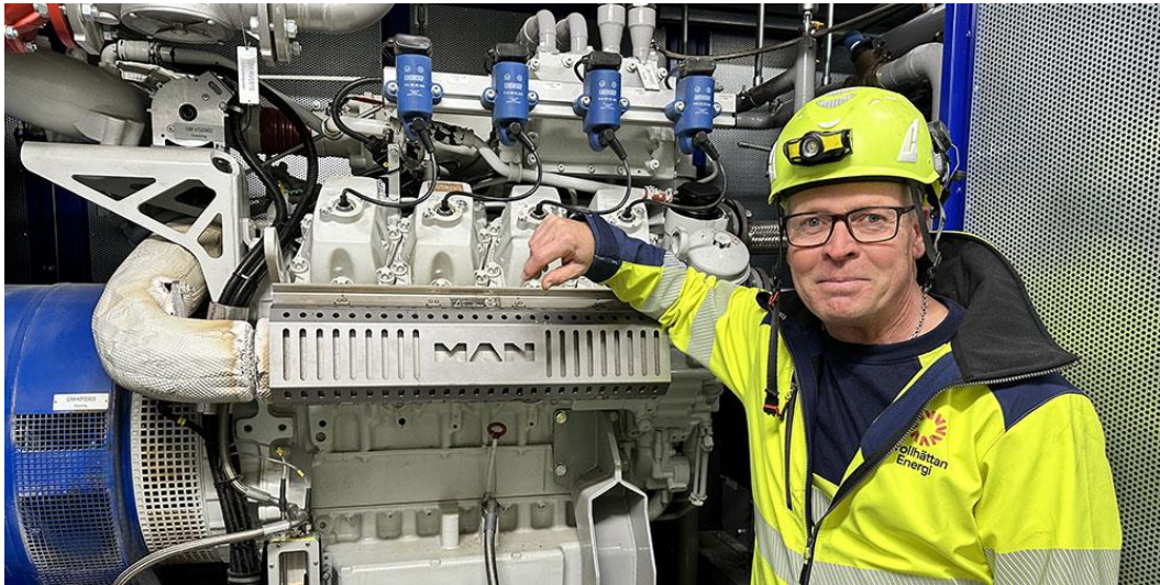
Bo Lindberg, drifttekniker på Trollhättan Energi, framför gasmotorn som genererar både el och värme.
